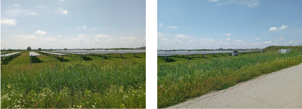
Slika 49. Izgrađena FOTONAPONSKA ELEKTRANA ŽUPANJA
